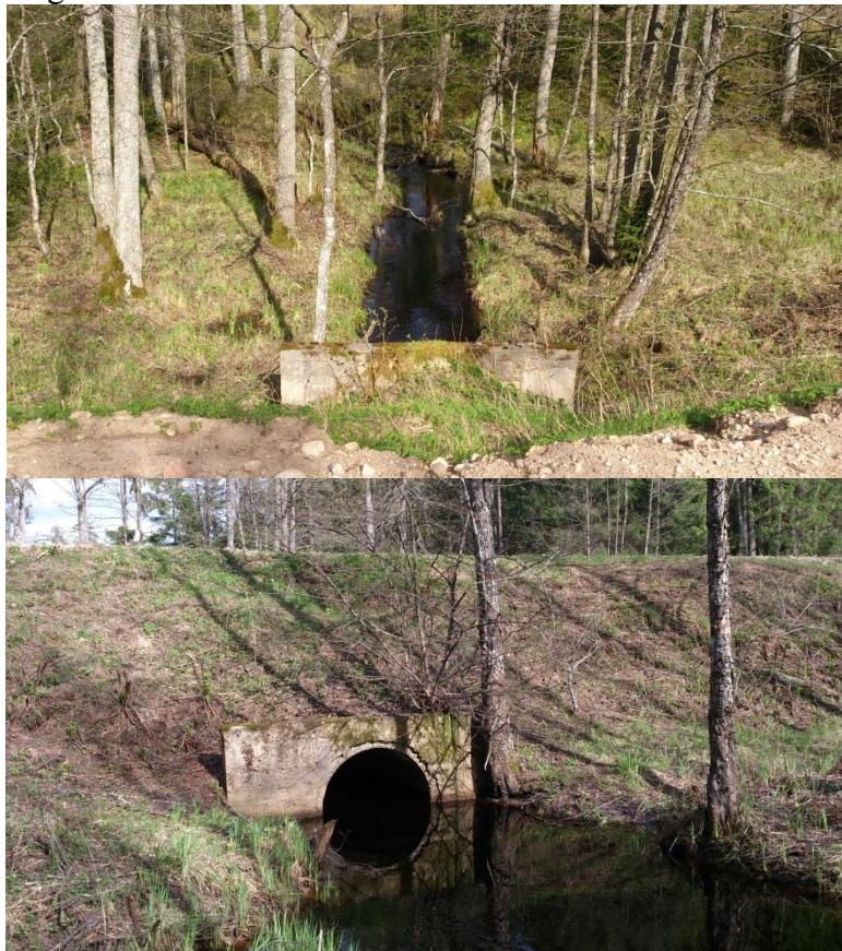
Caurteka uz Rudupes šķērsojumā ar meža autoceļu
