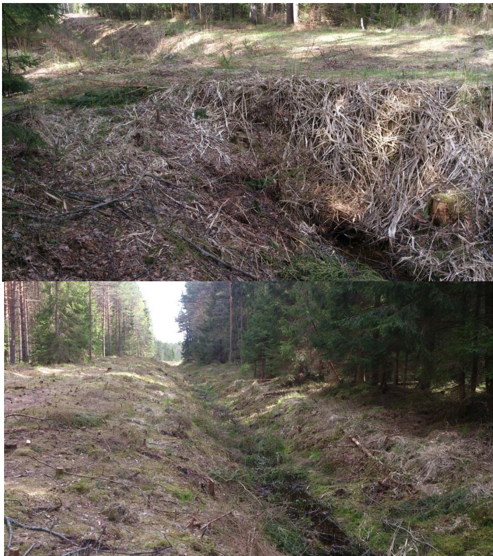
Piesērējusi caurteka Ø0,4m un novadgrāvis N-4 (skats purva virzienā) ~0,6km no ietekas Rudupē
