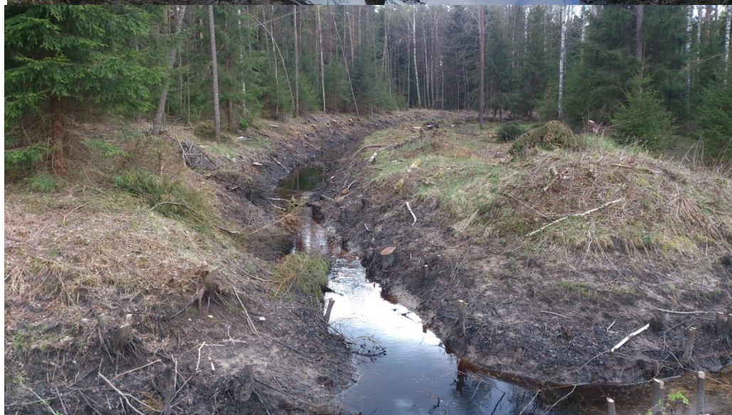
Piesērējusi caurteka Ø0,5m un novadgrāvis N-5 (skats purva virzienā) ~0,6km no ietekas Rudupē
